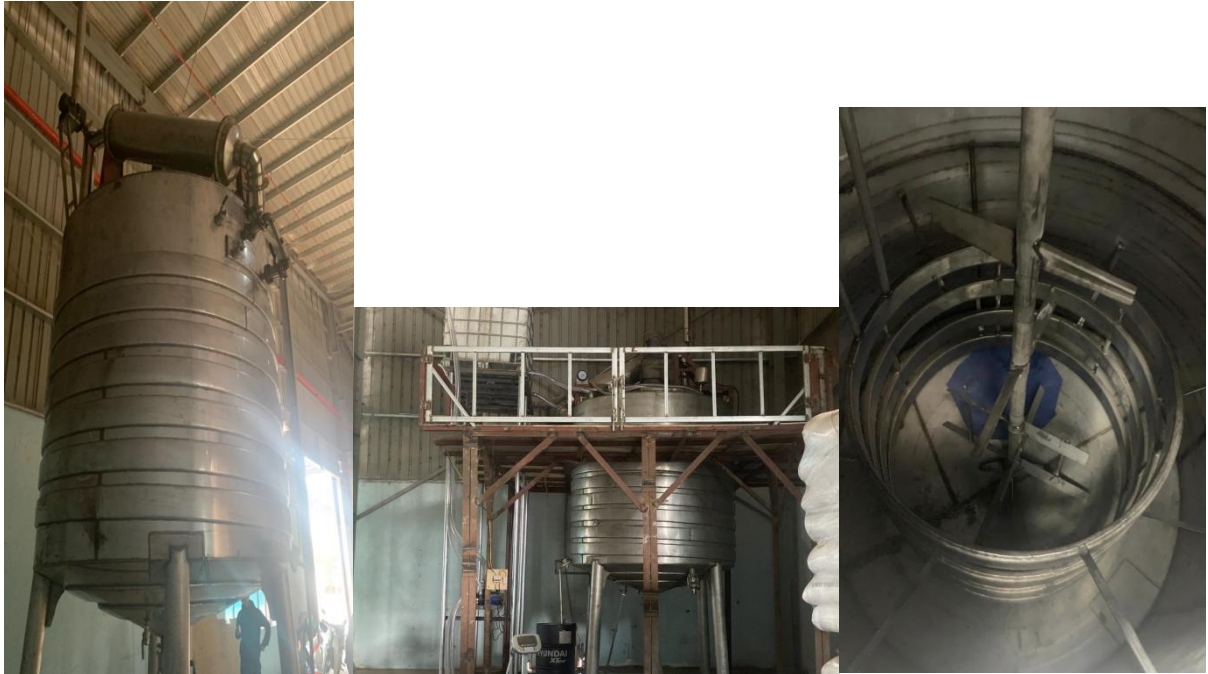
Hình 80. Hệ thống nồi nấu keo tại nhà máy
